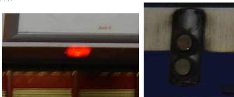
Signaux lumineux signalant la fermeture des portes à l'intérieur et à l'extérieur
